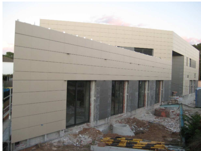
El bon ritme de les obres ja permet veure els detalls de la façana principal.
